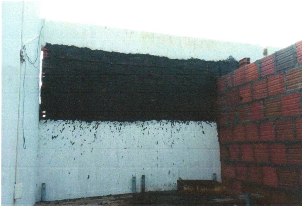
Foto 17 - CHAPISCO APLICADO EM ALVENARIA (COM PRESENÇA DE VÃOS) E ESTRUTURAS DE CONCRETO DE FACHADA, COM EQUIPAMENTO DE PROJEÇÃO. ARGAMASSA TRAÇO 1:3 COM PREPARO EM BETONEIRA 400 L. AF_06/2014
