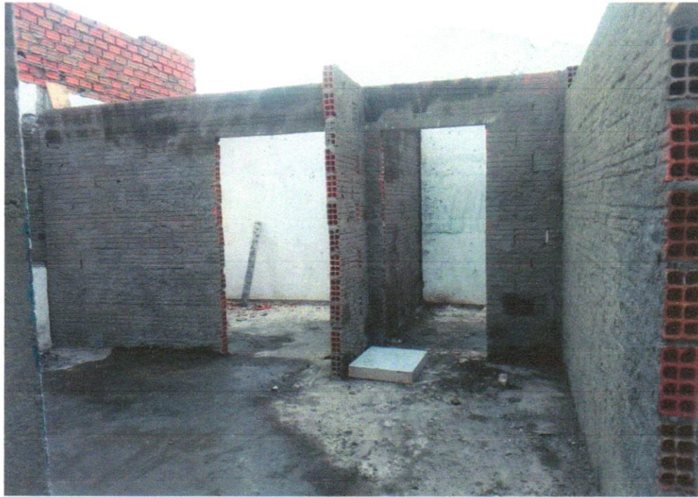
Foto 19 - CHAPISCO APLICADO EM ALVENARIA (COM PRESENÇA DE VÃOS) E ESTRUTURAS DE CONCRETO DE FACHADA, COM EQUIPAMENTO DE PROJEÇÃO. ARGAMASSA TRAÇO 1:3 COM PREPARO EM BETONEIRA 400 L. AF_06/2014
