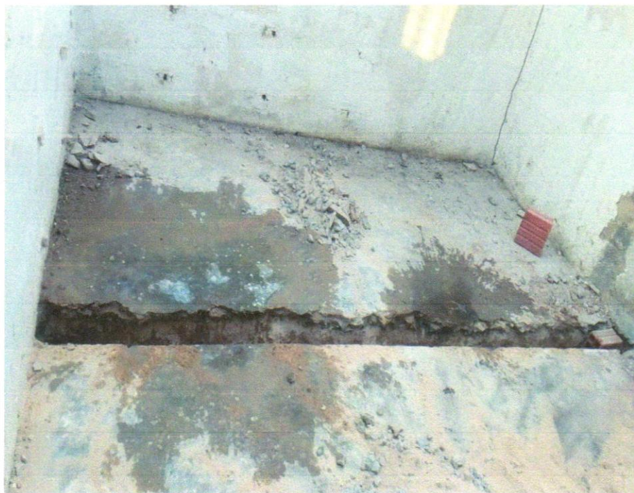
FOTO 07 - ESCAVAÇÃO MANUAL DE VALA PARA VIGA BALDRAME (INCLUINDO ESCAVAÇÃO PARA COLOCAÇÃO DE FÔRMAS). AF_06/2017
